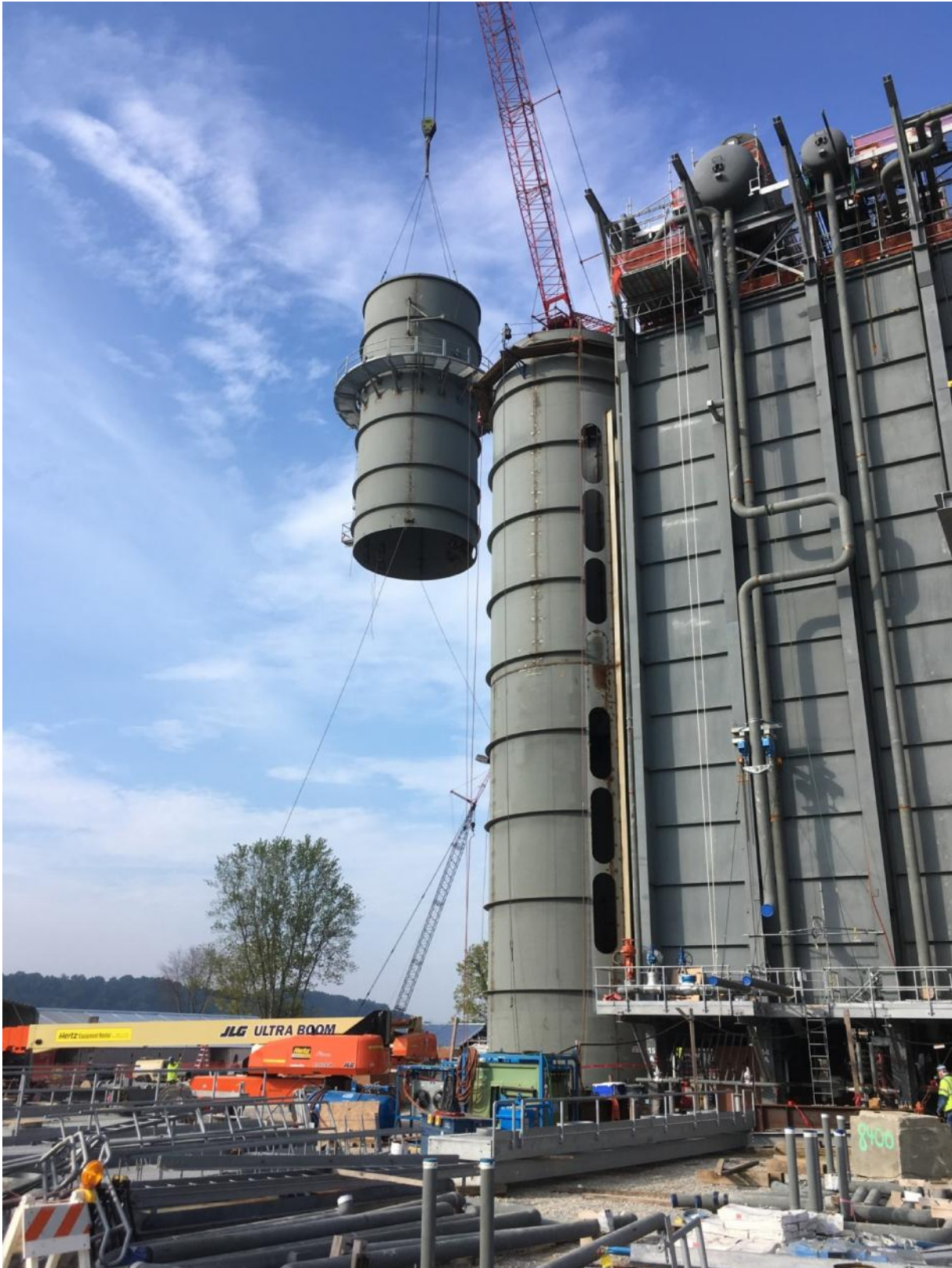
HRSG 2 Stack Top Section
